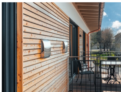
Edelstahlaußenhauben auf Holzassade
