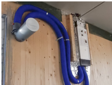
Unbegrenzte Einbaumöglichkeiten: Hier ausnahmsweise mit Zuluftverteilung anstatt des Überströmers
