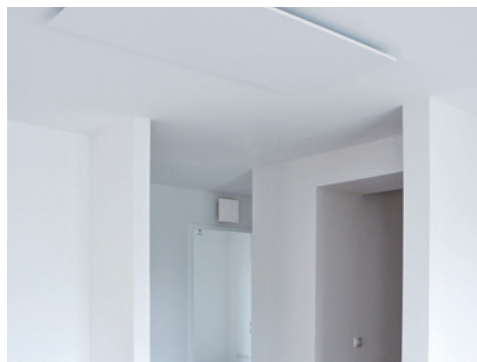
Infrarot Deckenheizung und freeAir plus Überströmer
