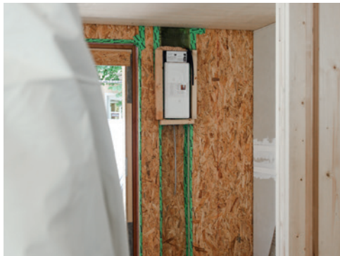
Rohbauset im Rohbau - Elektroleitungen bereits verzogen
